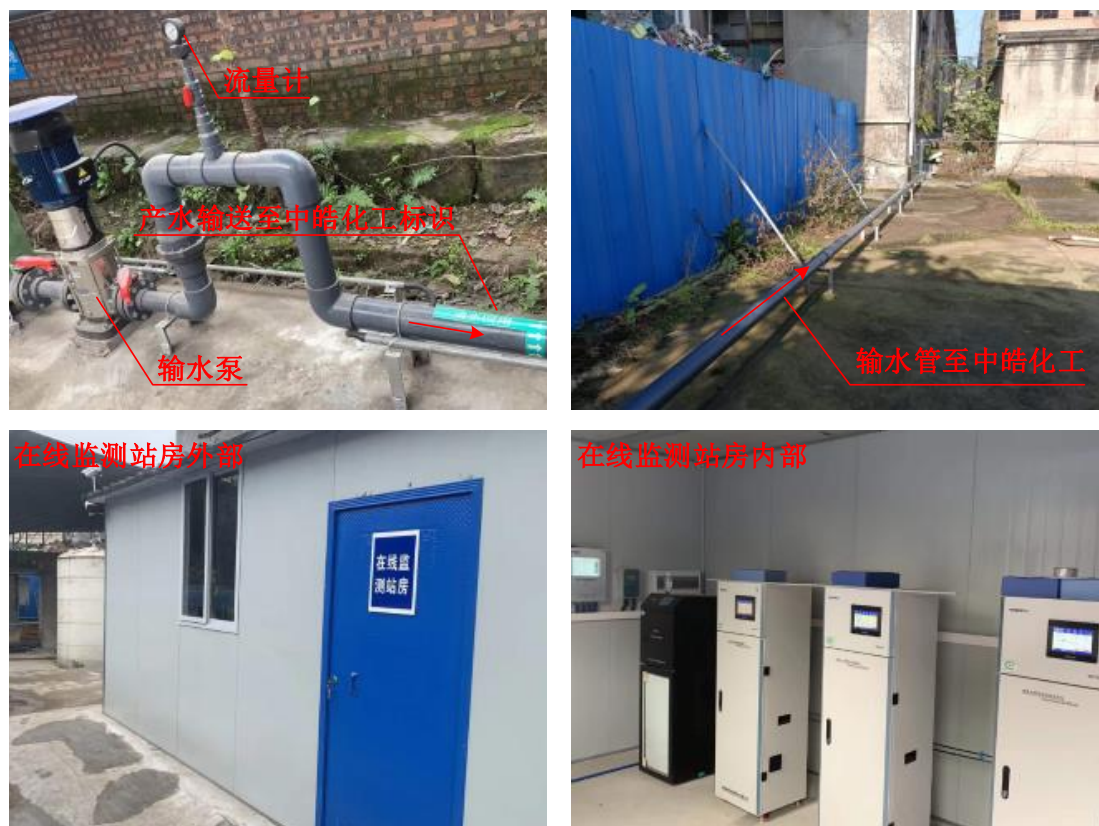
图 4.2-2 废水规范化排污口、监测设施及在线监测装置照片
